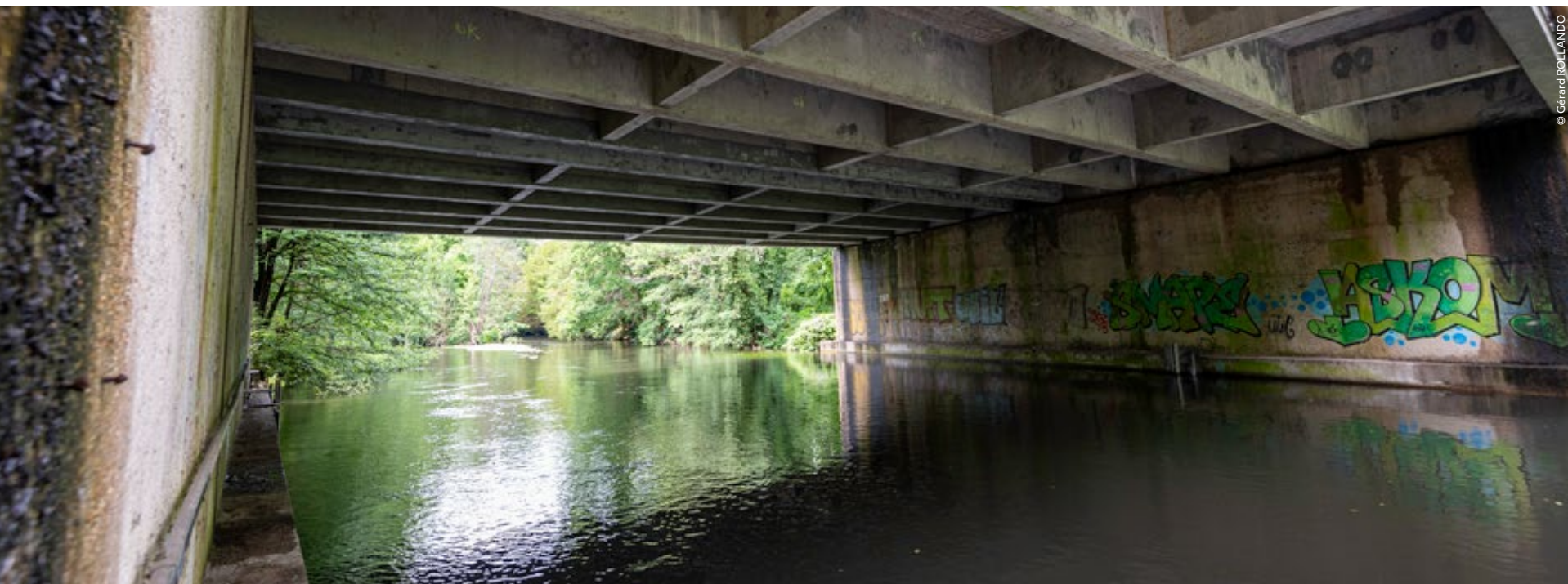
OUVRAGES DE L'A6 en franchissement des rivières et rus en Vallée de l'Essonne et Auvernaux
